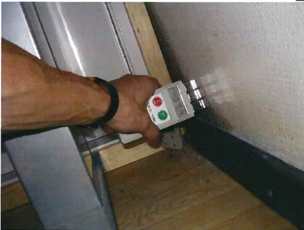
Fugtmåling i værelse mod nord viser fuldt udslag, svarende til kraftig opfugtning.
