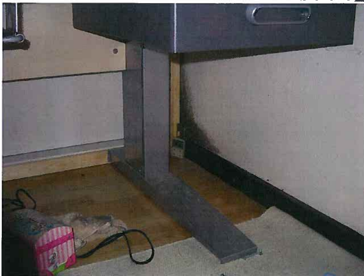
Skimmelaftægning på ydervæg i værelse mod nord.
