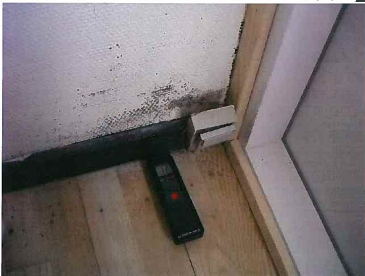
Skimmelfæstelse på ydervæg i værelse mod syd. Fodpanel opfugtet til niveau som maksimalt-vådt konstruktionstræ.
