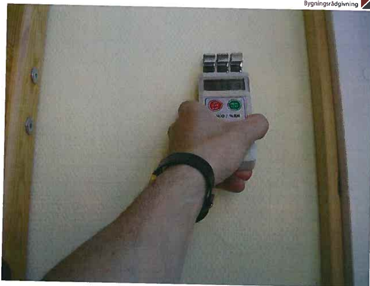
Fugtmåling i værelse mod syd i ca. 1,5m's højde. Niveau som normal ydervæg.
